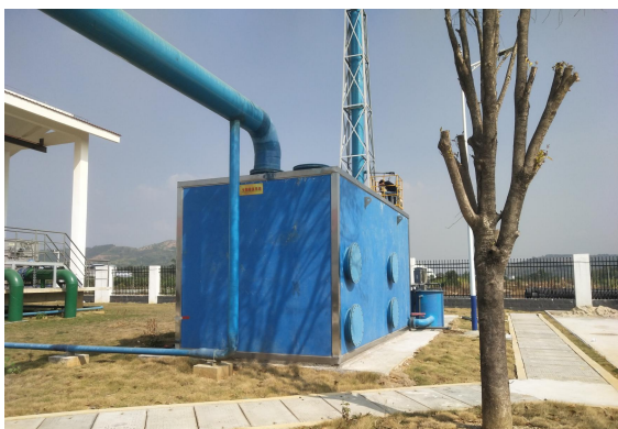
生物除臭系统
