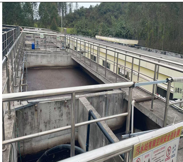
废水处理设施
