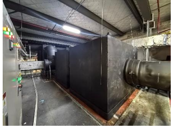
中试线活性炭处理设施
