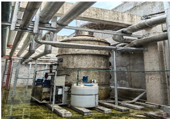
中试线碱喷淋处理设施
