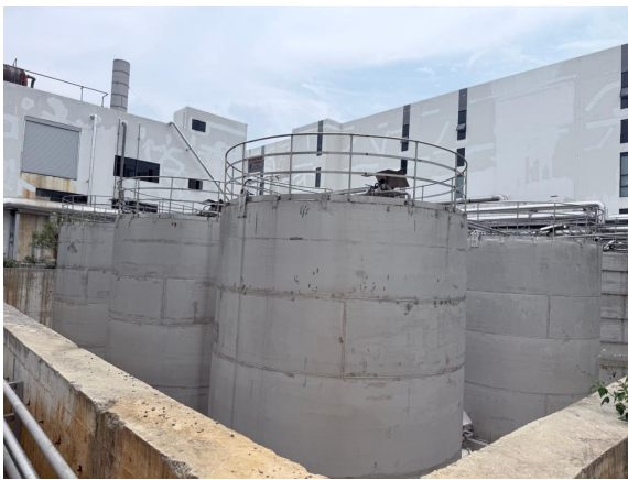
NMP 精馏塔废液储罐
