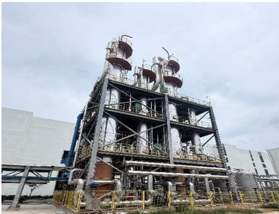
NMP 精馏塔主体
