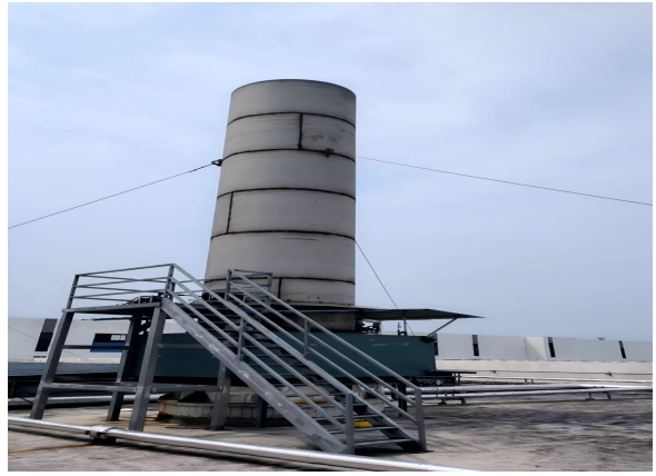
导热油炉排气筒
